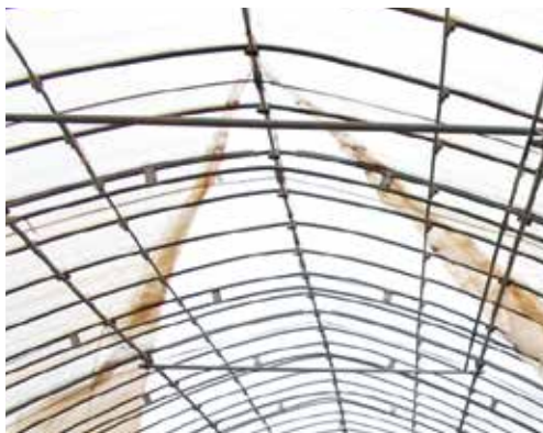
令和6年10月の風害による被覆材被害
